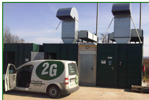
The 2G® Biogas CHP Module
